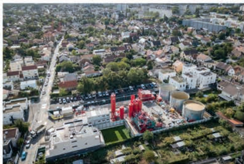
Centrale de fabrication et traitement de boue Grand Paris Express – 1501P T2A
